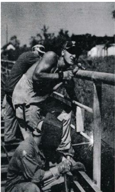
PIONIERS bouwen verkeersbrug en herstellen waterleidingsbuizen die langs de brug voeren. We zeiden bewonderend: „Machtig brokje werk”. Ze schudden ontevreden het hoofd, want die buizen en de brug lagen niet tot op de millimeter parallel aan elkaar.
